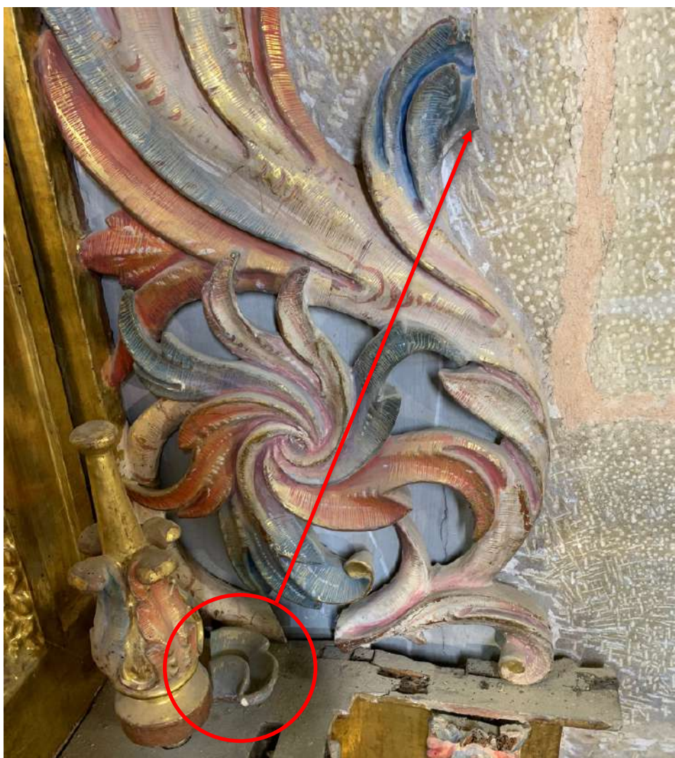
Detalle de fractura de una moldura de la parte derecha del ático del retablo de San Isidro
