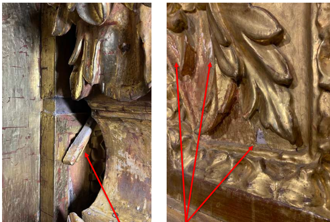
Detalle de moldura desencolada en el ático y levantamientos y disgregación puntual de intervenciones anteriores en la parte inferior del retablo
